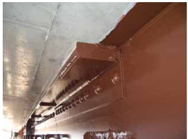
写真3 上フランジ補強板
